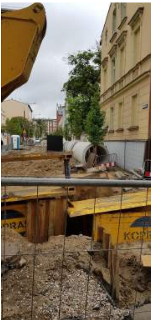
Zdj. 3. Brak zabezpieczenia drzew na ul. Reja (widok od strony ul. Skargi), źródło: modrzew.org.pl
